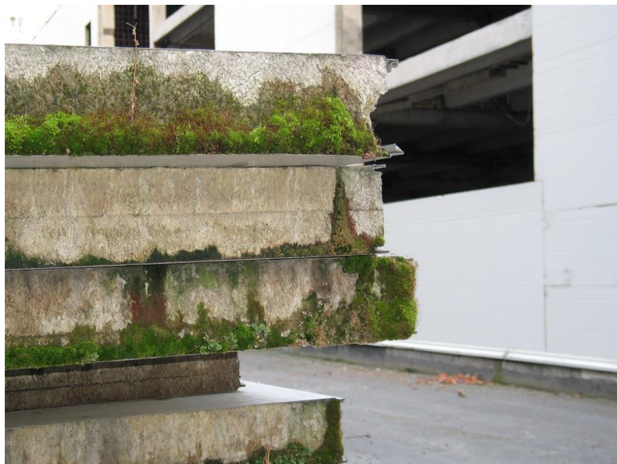
Рис.9. Биоповреждение сэндвич-панелей складированных на открытом воздухе.
