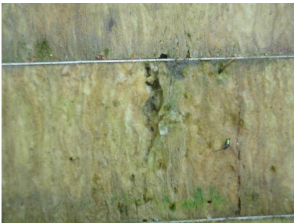
Рис.10. Биоповреждение сэндвич-панели с базальтовым волокном, через полтора года с момента установки
